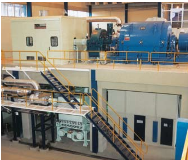
Cliente: USINA CERRADINHO Pais: Brasil Suministros: Generador de 31.250 kVA, 13.800 V, 4 polos Transformador, CCM, Paneles, Sistemas Supervisores Aplicación: Turbina a vapor (Usina de azúcar y alcohol) Combustible: Bagazo de caña
