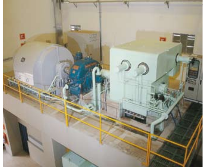
Cliente: USINA COLOMBO Pais: Brasil Suministro: 18.750 kVA, 13.800 V, 4 polos Aplicación: Turbina a vapor (Usina de azúcar y alcohol) Combustible: Bagazo de caña
